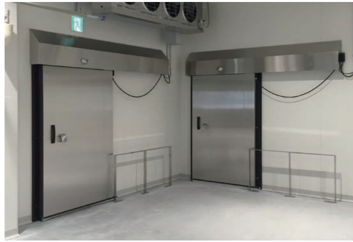
豊洲市場に導入された防熱扉
