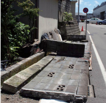
出典：消防防災科学センター(災害写真データベース)
