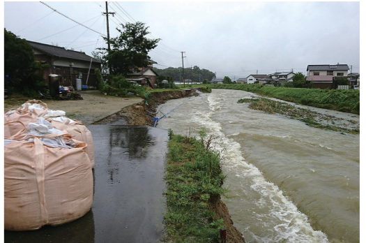
7月の西日本豪雨で堤防が損傷した金倉川(まんのう町)
