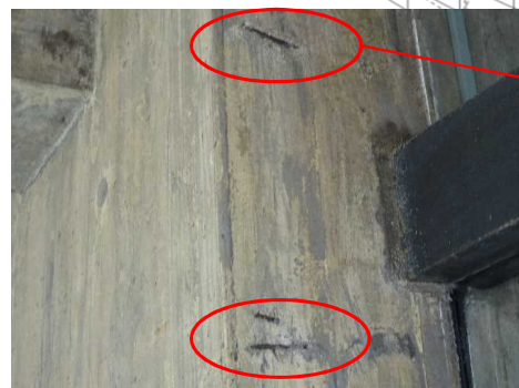
【柱】 鉄筋腐食によるコンクリートの剥離、 鉄筋の露出
