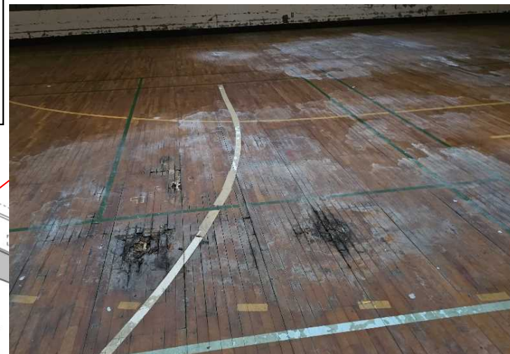
【床】雨漏れによる著しい床フローリング材の腐食
