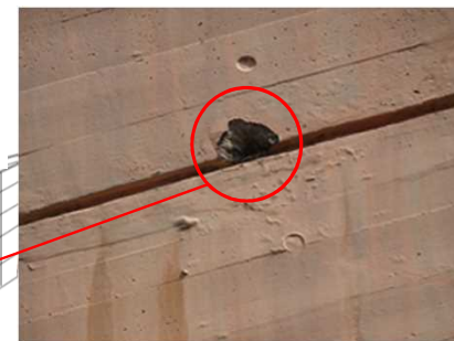
【外壁】 鉄筋腐食によるコンクリートの剥離、 鉄筋の露出
