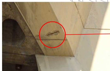
【梁下】 鉄筋腐食によるコンクリートの剥離、 鉄筋の露出
