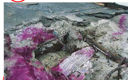
【屋根※】 コンクリート板の中性化の進行 （中性化している部分は検査液 の赤紫色に変化していない）
