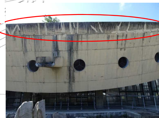
【外壁】 コンクリートのひび割れ
