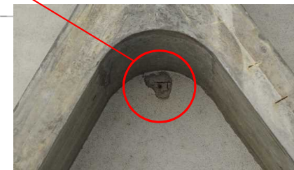
【軒下】 鉄筋腐食によるコンクリートの剥離、 鉄筋の露出
