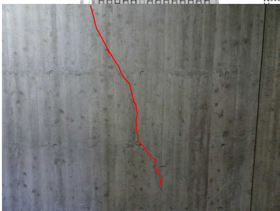
【廊下】コンクリート壁のひび割れ
