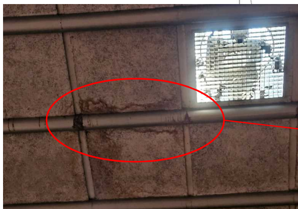
【天井】屋根板劣化による雨漏れ
