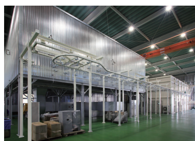
粉体塗装設備
