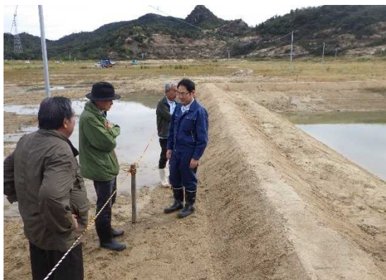
写真3 工事中の浸透池D西の視察
