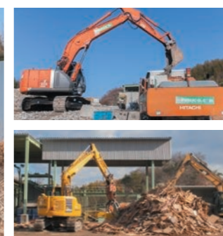
木くず破砕施設
