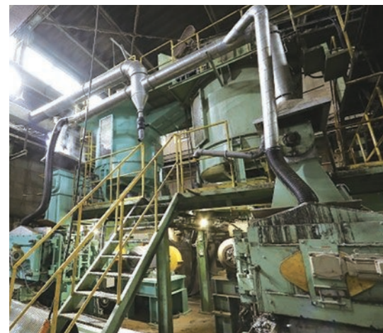
固形燃料化施設
