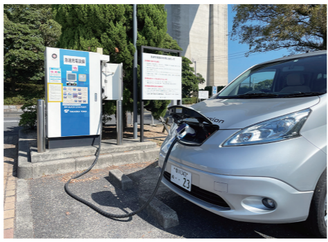
瀬戸大橋記念公園に設置の電気自動車用急速充電器
