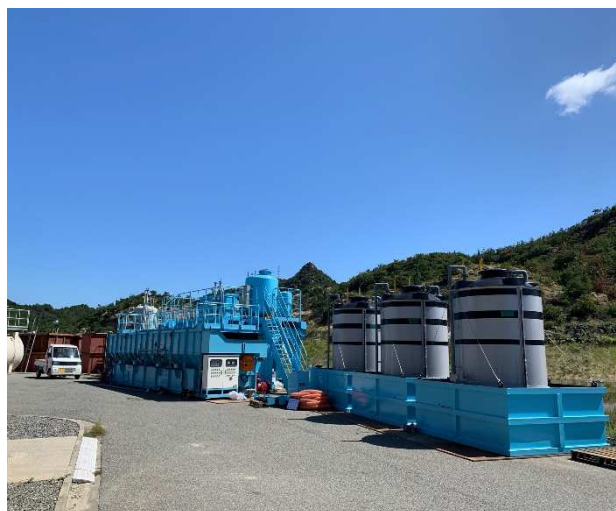
写真2 増設した装置の全景（手前は薬品タンク）
