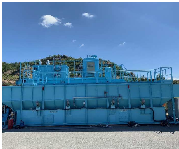
写真1 凝集沈殿装置及び砂ろ過装置
