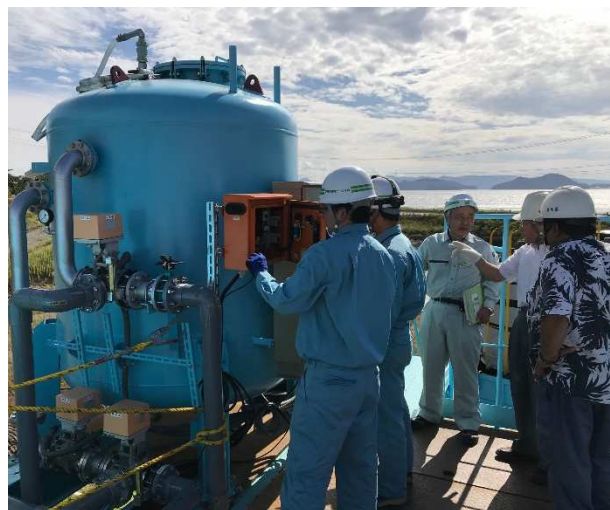
写真4 砂ろ過装置の確認の状況
