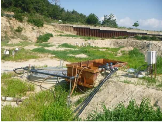
写真2 集水井ポンプ等の状況 (送水ポンプ及び送水管の増強、流量計の修繕)
