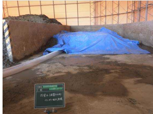
写真4 ガス吸引処理の状況
