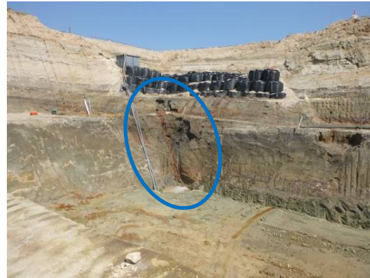
写真 1 4 湧水の状況 (区画⑬側から)
