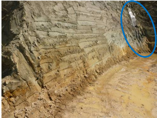
写真 1 3 湧水の状況 (区画④側から)
