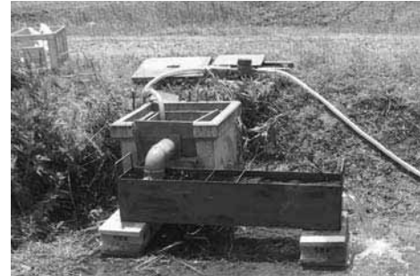
写真1 取水量の測定用三角堰
