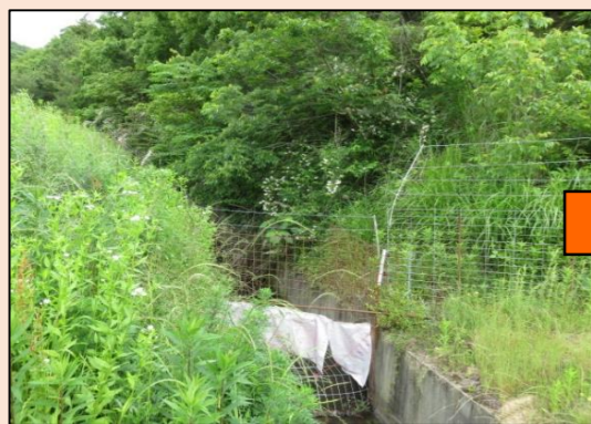
× 柵の上部を木が覆っていた
