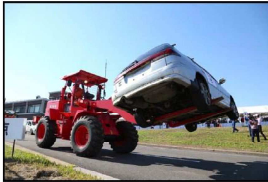
写真 フォークリフトアタッチメント付ホイールローダーによる車両移動 【出典:災害対策基本法に基づく車両移動に関する運用の手引き (平成26年11月 国土交通省道路局)】
