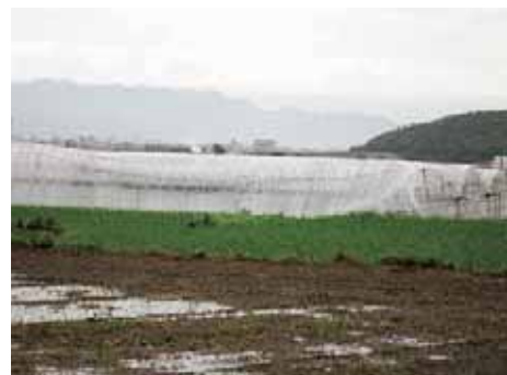
強風により倒壊したハウス
