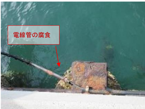
写真5 電線管の腐食状況
