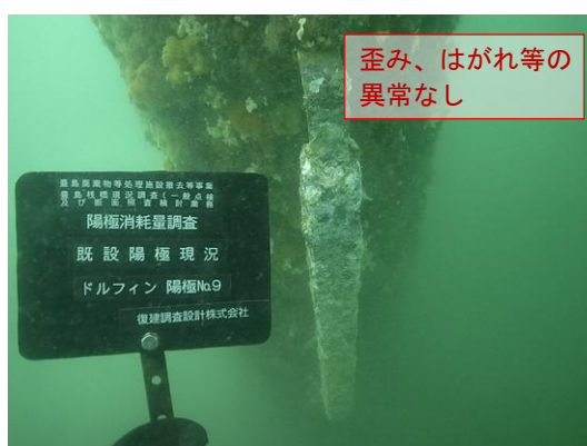
写真1 陽極材の全景（ドルフィン）
