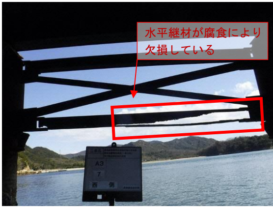
写真3 水平継材の腐食状況
