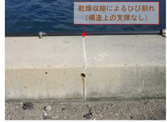
写真⑦ コンクリート部のひび割れ状況
