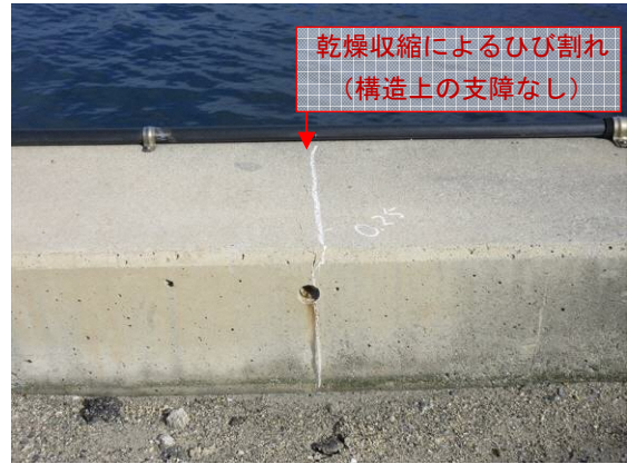
写真4 コンクリート部のひび割れ状況
