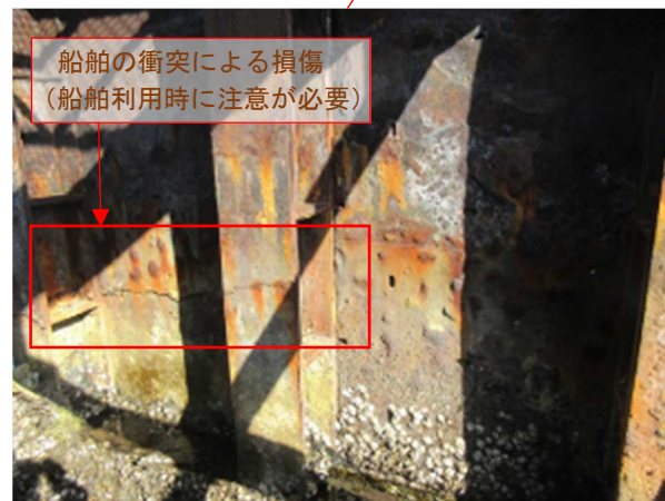
写真⑬ 防舷材固定部損傷状況
