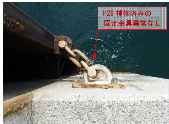
写真6 防舷材固定金具の状況
