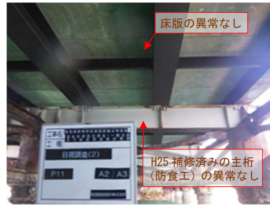
写真② 主桁・受桁 (11, A2A3)
