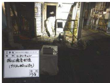
④デジタル粉じん計の設置（溶融炉側）
