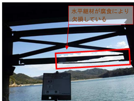
写真⑤ 水平継材の腐食状況
