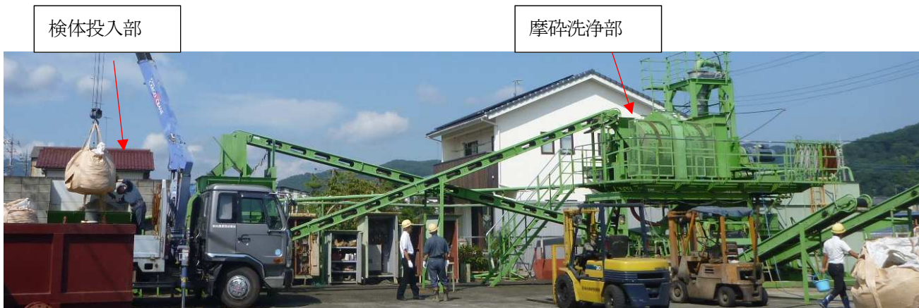
写真1 摩砕洗浄システム
