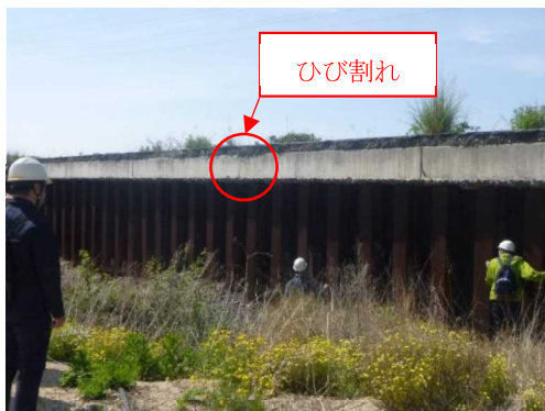
写真5 笠コンのひび割れ状況（全景） （FG 測線の間近付）
