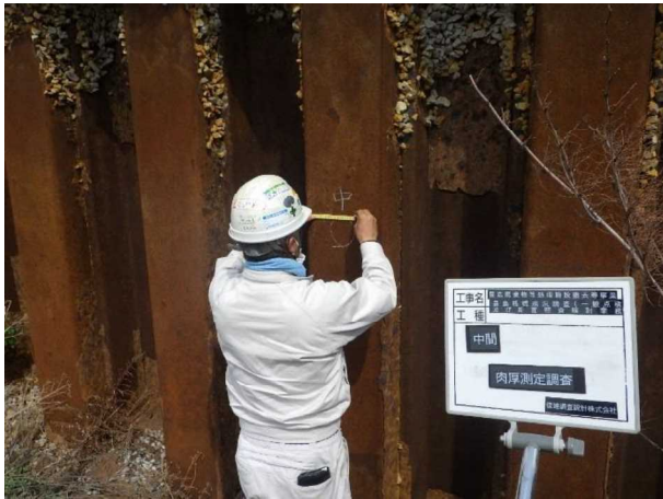
写真3 肉厚測定箇所-研磨前 (中間)
