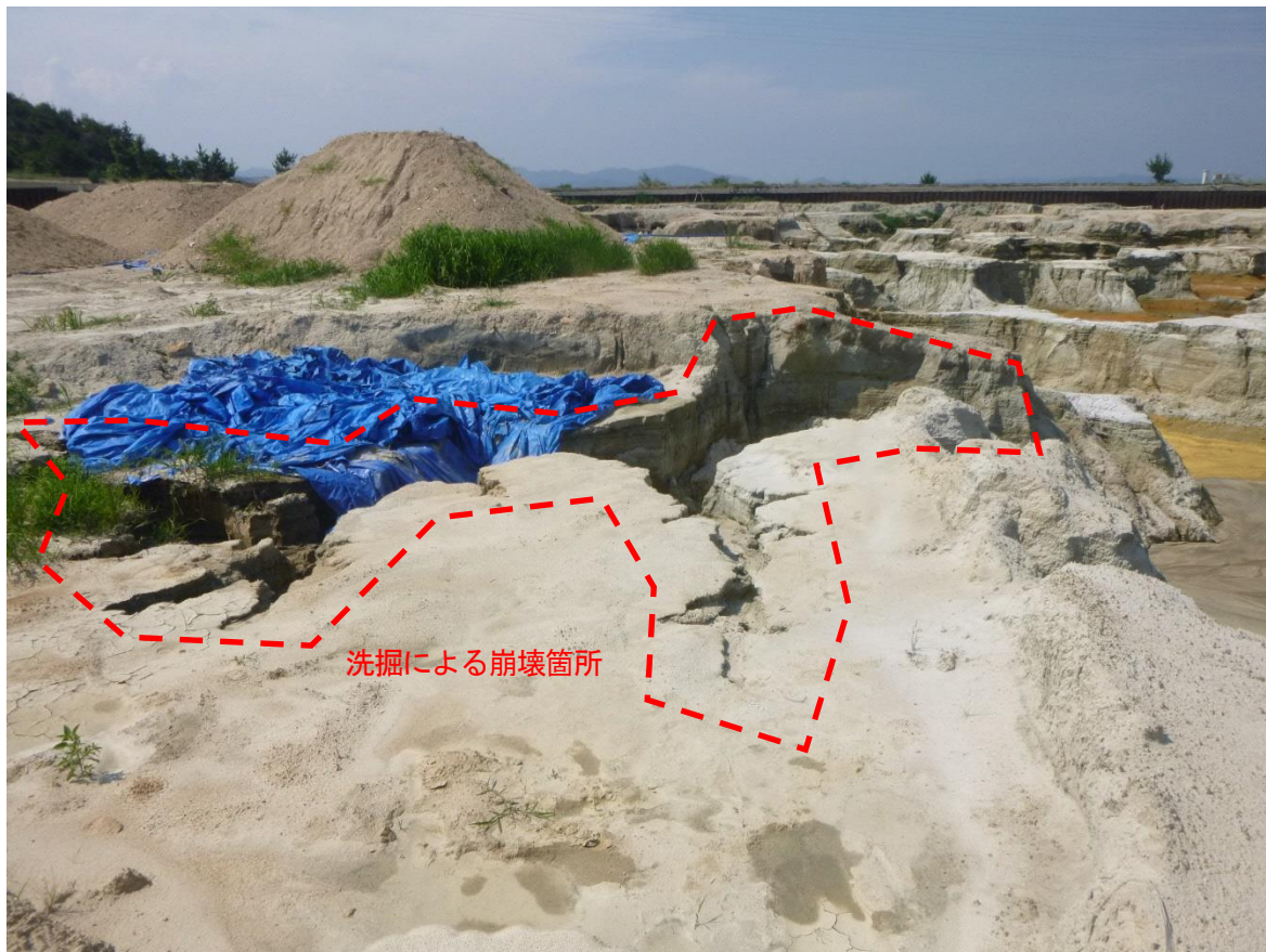
写真2 つぼ掘りの現状（元々平地であった箇所が洗掘を受けた事例）
