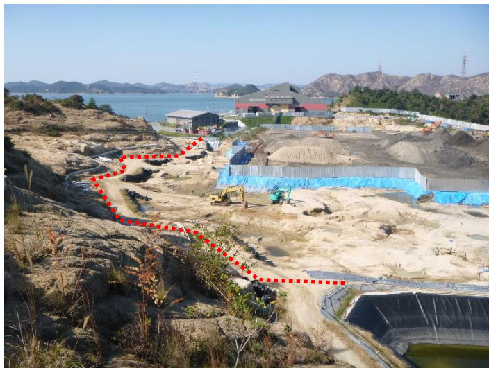
写真3 送水管(H26設置時)
