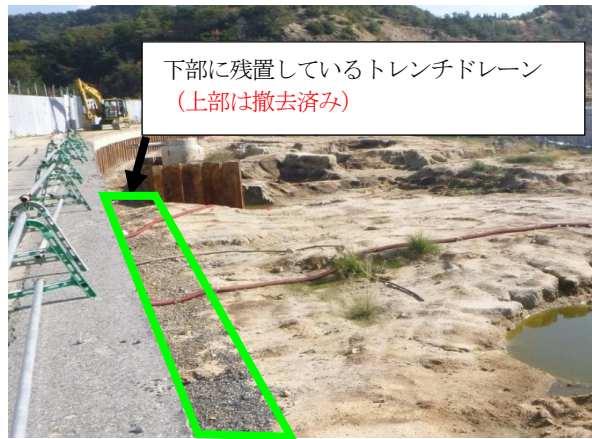
写真1 現在の北海岸遮水壁沿いのトレンチドレーン
