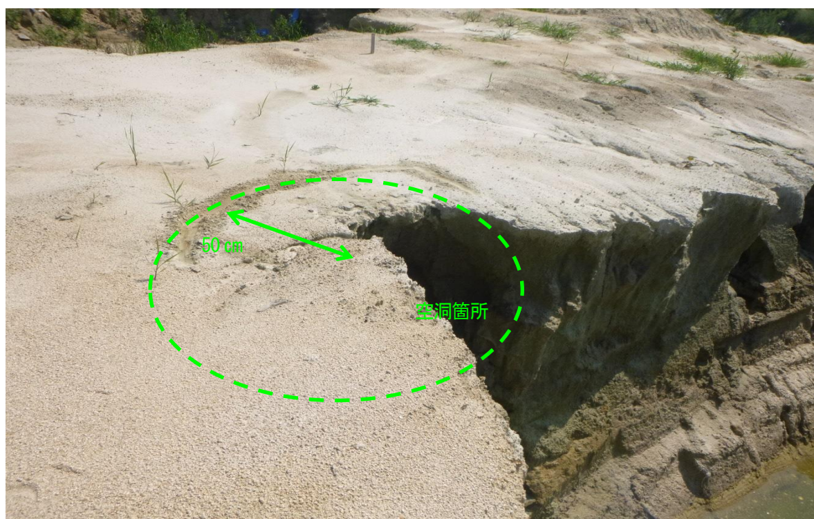
写真3 つぼ掘りの現状（地中内に空洞が生じている事例）
