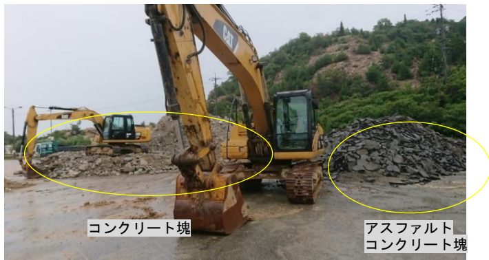
写真7 コンクリート塊等の集積状況
