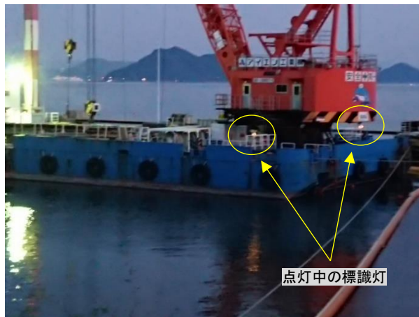
写真15 標識灯の点灯状況
