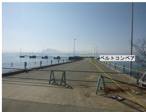
写真10 ベルトコンベア (陸側→海側向き)
