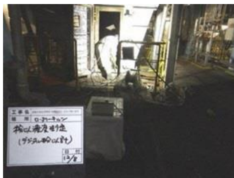
④ デジタル粉じん計の設置 (溶融炉側)
