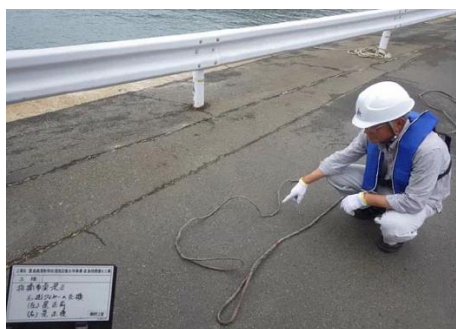
鋼管吊り上げ用のワイヤーの交換 （左側 是正前、右側 是正後）
